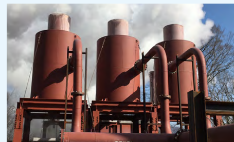
秋田県小安地域の水蒸気噴気試験用設備
