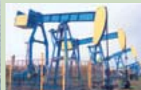
八橋油田ポンピングユニット
