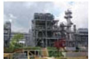
ガス処理プラント・新規系列
