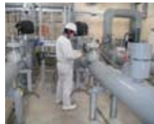
バルブステーション構内点検
