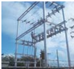
受電施設のメンテナンス
