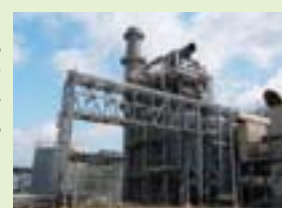
発電プラント
