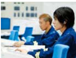
中央操作室の様子
