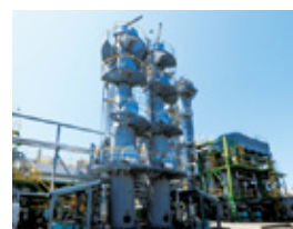
南長岡ガス田越路原プラント
