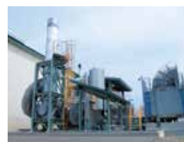
排ガスを利用した発電設備
